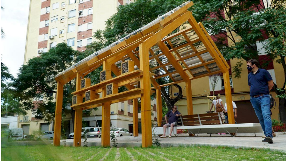
Solución Basada en la Naturaleza en construcción en València en el marco del proyecto GrowGreen
